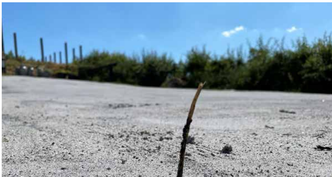
Nylagt asfalt fyldt med revner og ekstra sand for at skjule fejl
